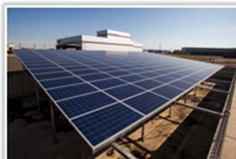
太陽光発電設備
